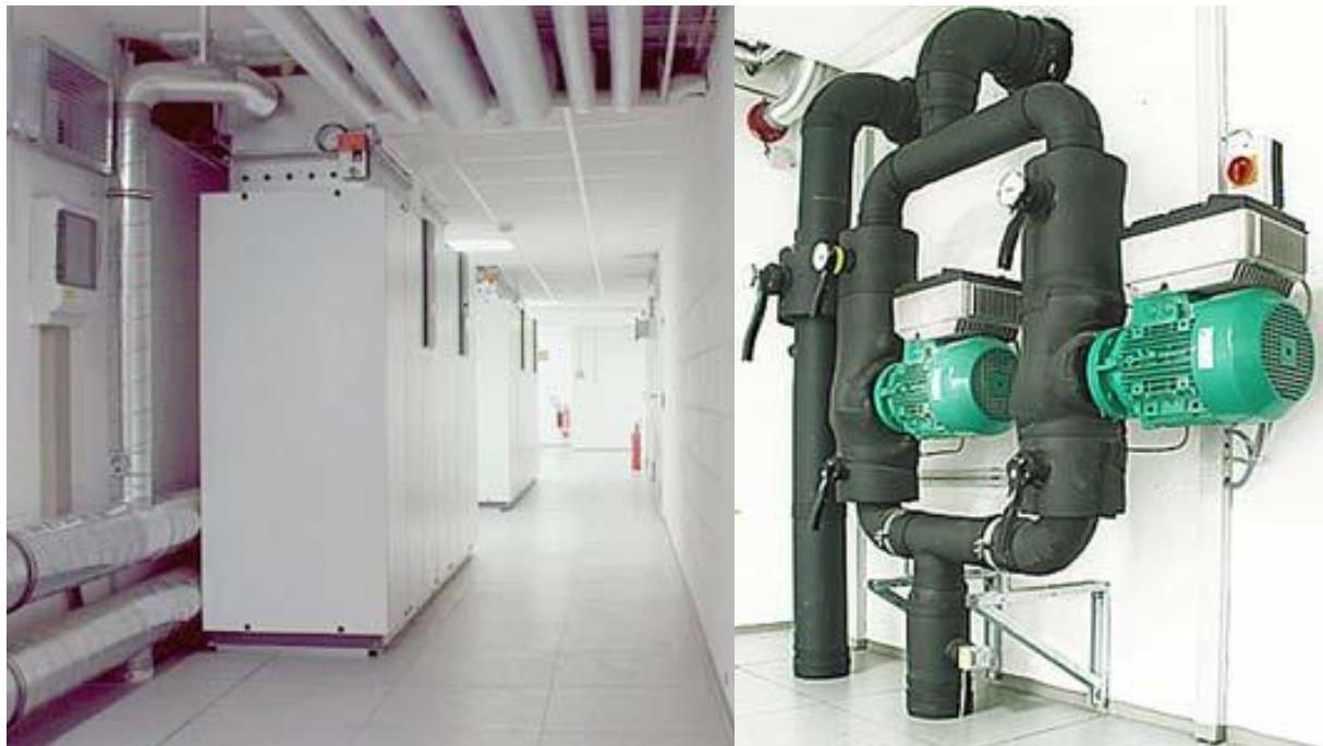
Abbildung 6: redundante Klimatisierung / redundant ausgelegte Kältemittelpumpen
