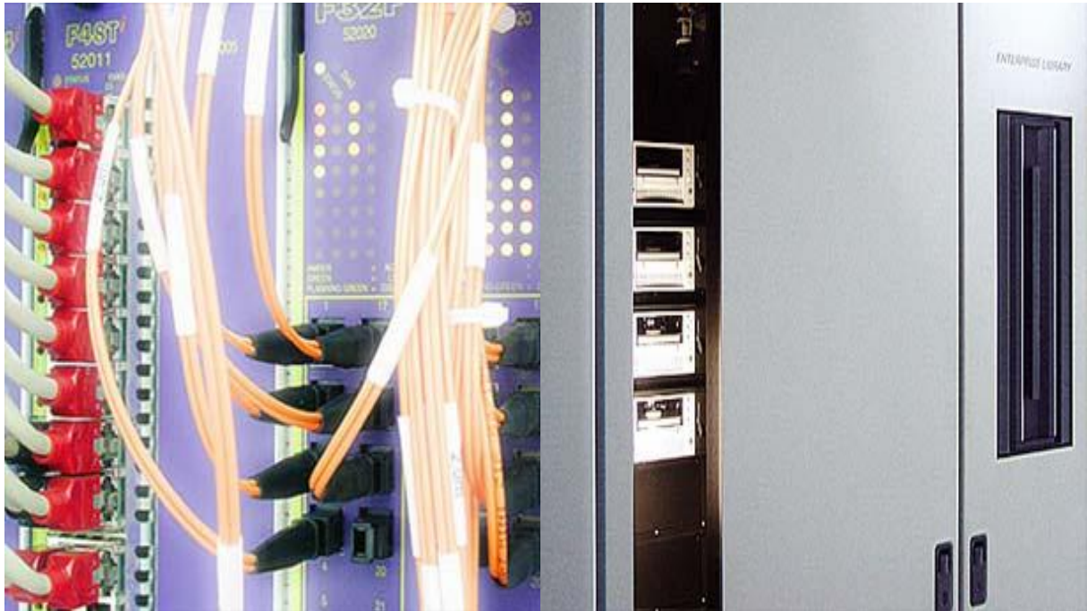
Abbildung 10: LWL-Verkabelung am Black Diamond Zentralswitch / Compaq Enterprise Library
