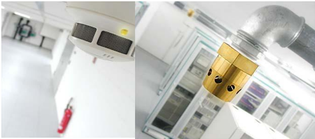
Abbildung 7: Feuermelder mit Funktionssteuerung für die Rauchschutztüren / Löschdüse für FM 200 Löschmittel Serverraum 2
