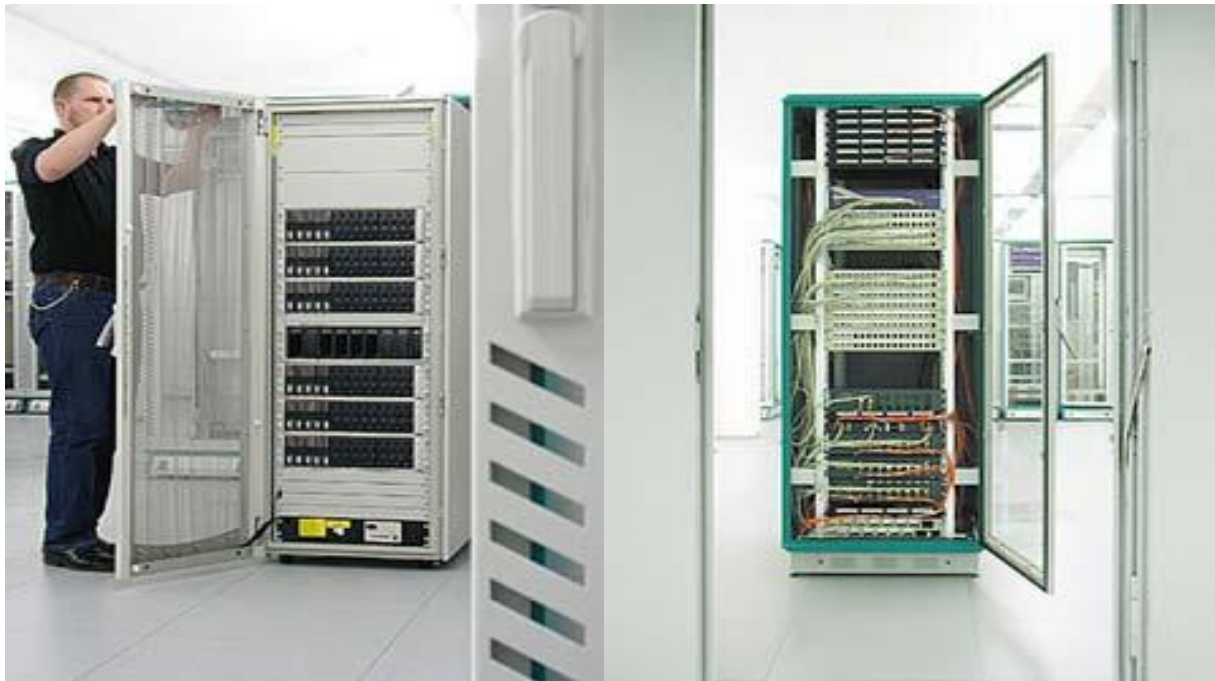
Abbildung 11: Betreuung einer SAN-Umgebung / Netzverteilerschrank
