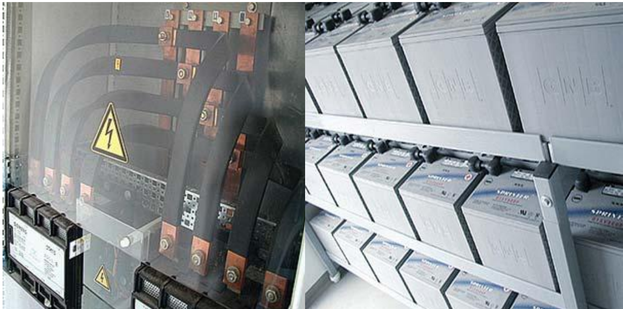
Abbildung 4: Steuerung Notstrom-Dieselaggregat / unterbrechungsfreie Stromversorgung
