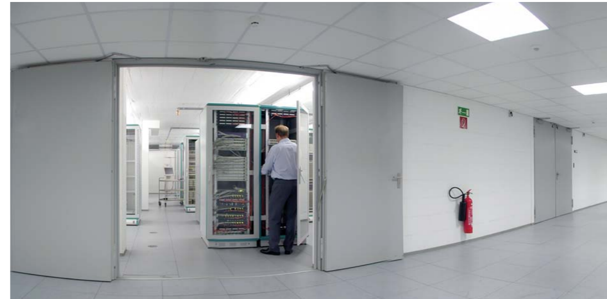
Serverraum im RZ
